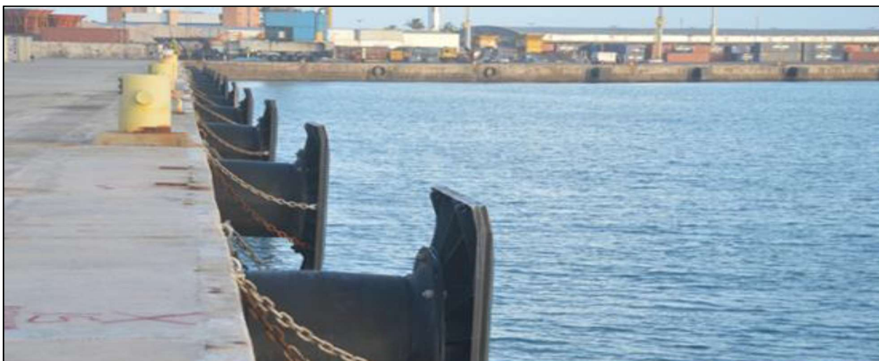
Figura 8: Cabeços de amarração e defensas do Porto de Fortaleza.
